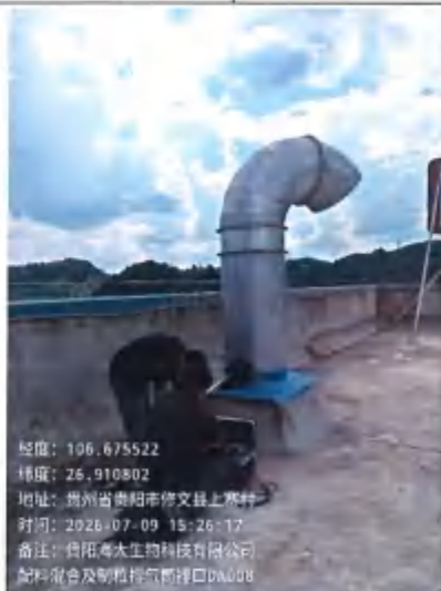
配料混合及制粒排气筒排口 (DA008)
